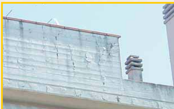
Fenomeno di distacco del copriferro.
