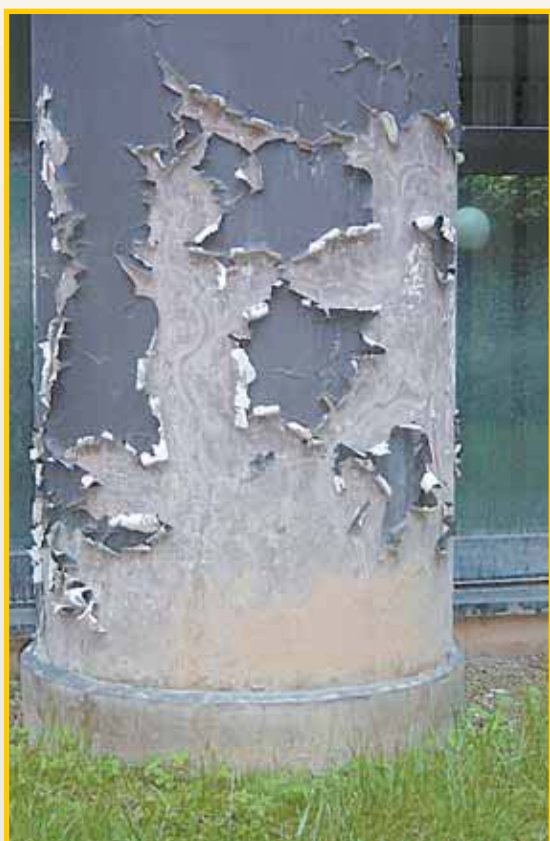
Esfoliazione della pellicola di rivestimento causata dall'utilizzo errato di un materiale sintetico impermeabile.
