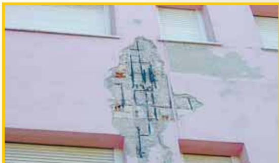
Struttura in cemento armato con ferri d'armatura scoperti e deteriorati dai sali.
